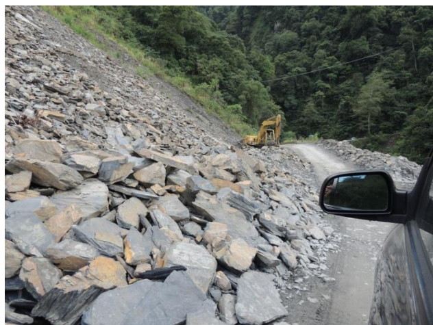
每逢雨季就大崩塌的路段
